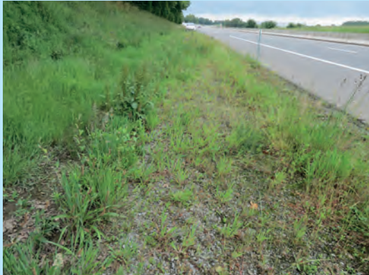
Accotement peu végétalisé avec zones nues. © Cerema
