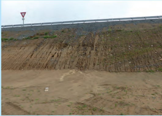
Érosion de talus avant végétalisation. © Cerema
