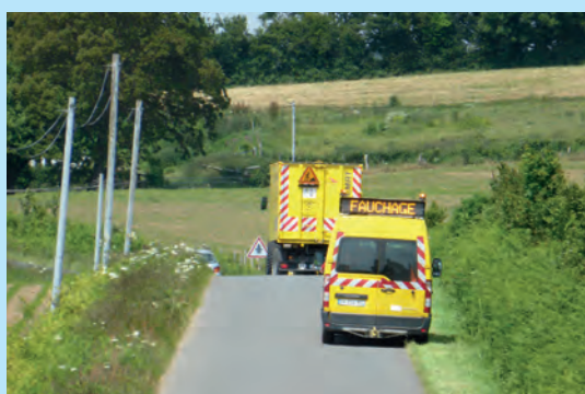
Balisage de sécurité. © Cerema
