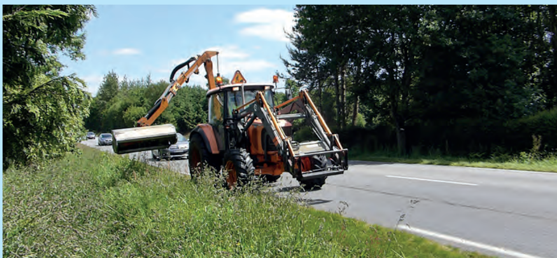
Gestion des accotements en pointillés ou ponctuelle par épaveuse (100 m sans broyage tous les km). © Cerema
