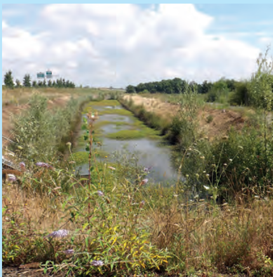
Envahissement par la jussie d'un bassin d'assainissement routier. © Cerema
