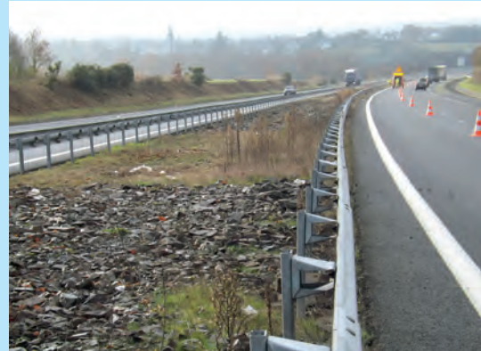
Matériaux caillouteux sur terre-plein central. © Cerema
