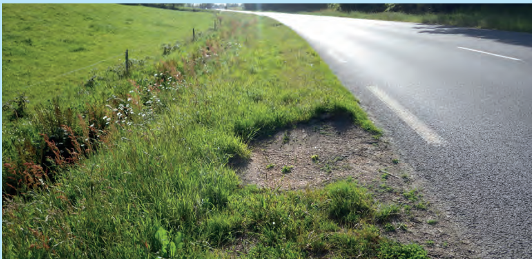
Saignée d'accotement pour gestion des eaux. © Cerema
